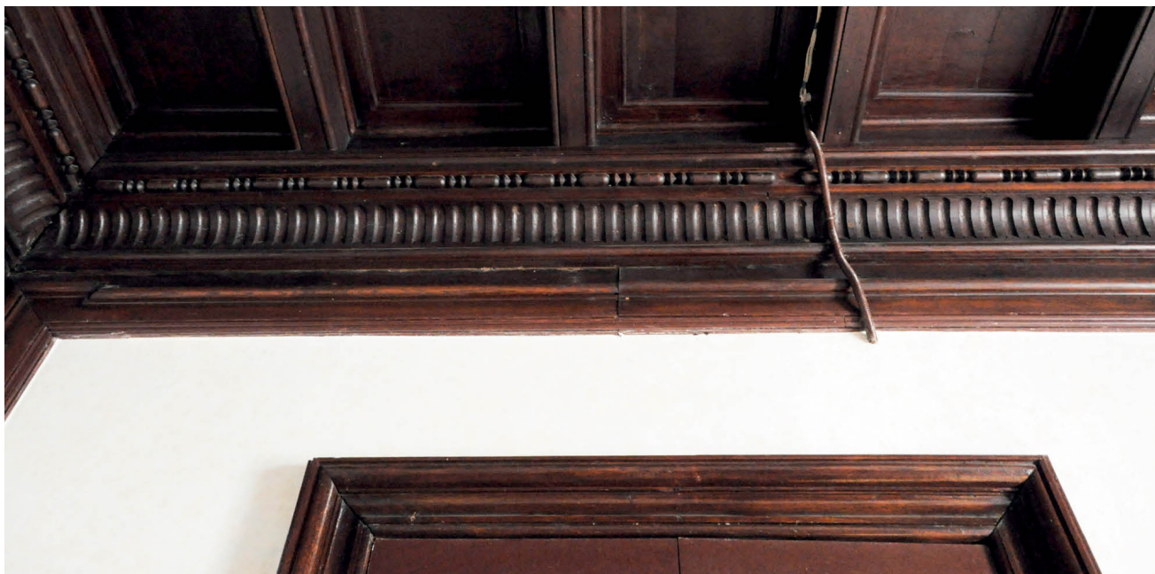
Antoniny - strop i faseta boazerii w kasynie urzędniczym, fot. W. Żurawski 2011 r.
